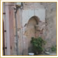
Gazipaşa Mahallesi, Ay Sokağı. Duvar çeşmesi görünümündeki çeşme bakımsız haldedir.
