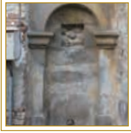
Gazipaşa Mahallesi İncirli Mescit Caddesi. Duvar çeşmesi görünümündeki çeşme bakımsız haldedir.
