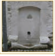
Talatpaşa Mahallesi, Tabak Çıkmağı. Çeşme bakımsız haldedir.
