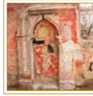
Turabey Mahallesi. Çeşme bakımsız haldedir.
