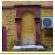
Talatpaşa Mahallesi, Samanpazarı Sokak. 454 ada 6 parselde, evin duvarındaki çeşme bakımsız haldedir.
