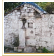
Ulucami Mahallesi, Menekşe Çıkmağı. Kesme taş ve moloz taştan inşa edilen çeşme bakımsız haldedir.
