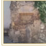
Talatpaşa Mahallesi. Tuğla örgülü olarak inşa edilmiş çeşme harap haldedir.
